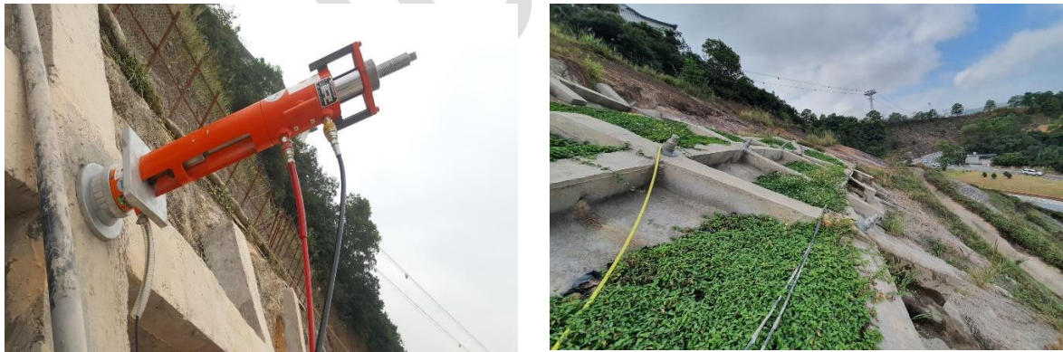
Hình 36: Dự án thí điểm áp dụng công nghệ neo đất SEED tại cầu Bãi Cháy, tỉnh Quảng Ninh.
